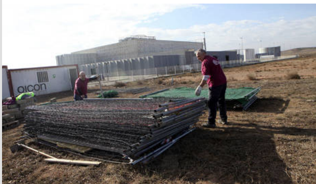
Dos operarios trabajan en el cerramiento de la parcela donde se ubicará el 'puerto seco'. N.G. LANDA
